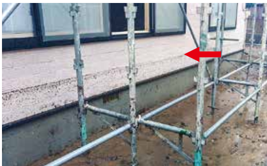
▲外壁に残る浸水の跡
