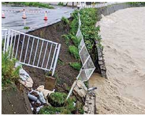
大雨で崩壊した吾妻川の護岸
