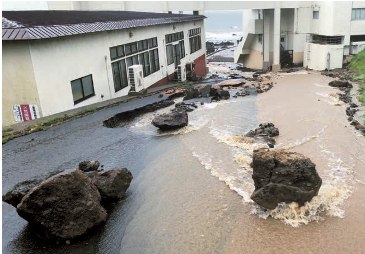
▲大雨により大きく陥没した不老ふ死温泉敷地内
