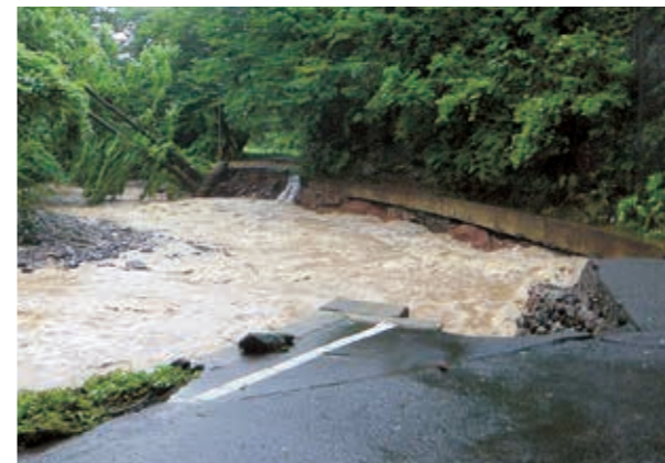
▲道路が崩落した長慶平1号線
