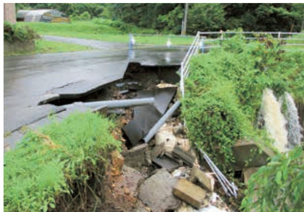
▲フィットネスプラザ「ゆとり」へ向かう道路は、片側が崩落し危険な状態に
