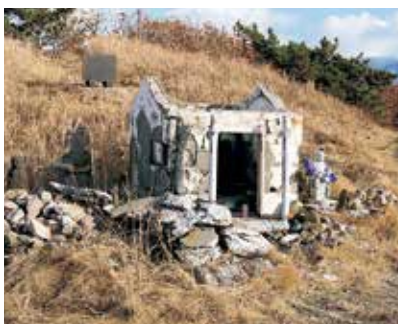
▲屋根が破損した賽の河原の祠(森山地区)
