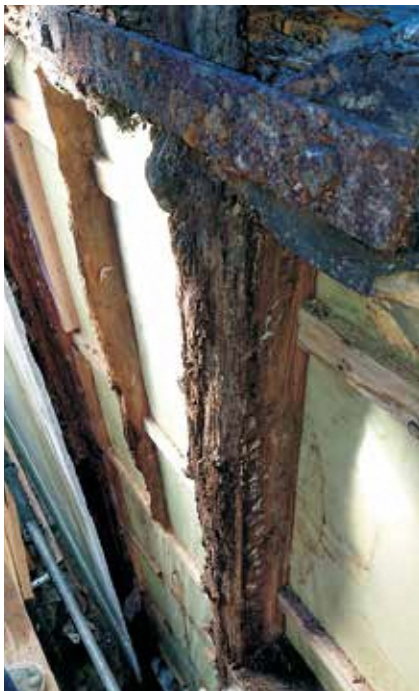
▲腐食が著しい外壁面の柱 (太宰の宿 ふかうら文学館)
