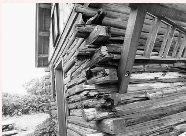
山頂の厳しい風雪にさらされ、腐食が著しい避難小屋の壁
