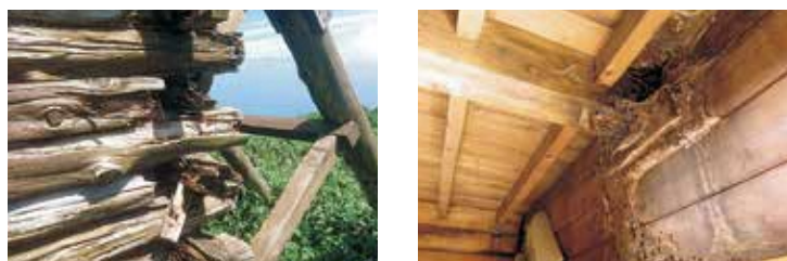
▲腐食が著しく倒壊の恐れがあるため、今年度改修する。
