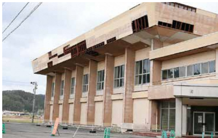
▲老朽化の著しい岩崎スポーツセンター(海側)
